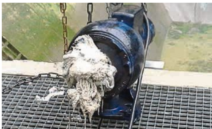
Die Verstopfte Schmutzwasserpumpe der Gemeinde.
